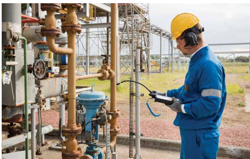
Rysunek 6 Kontrola instalacji przy użyciu miernika SDT 340
