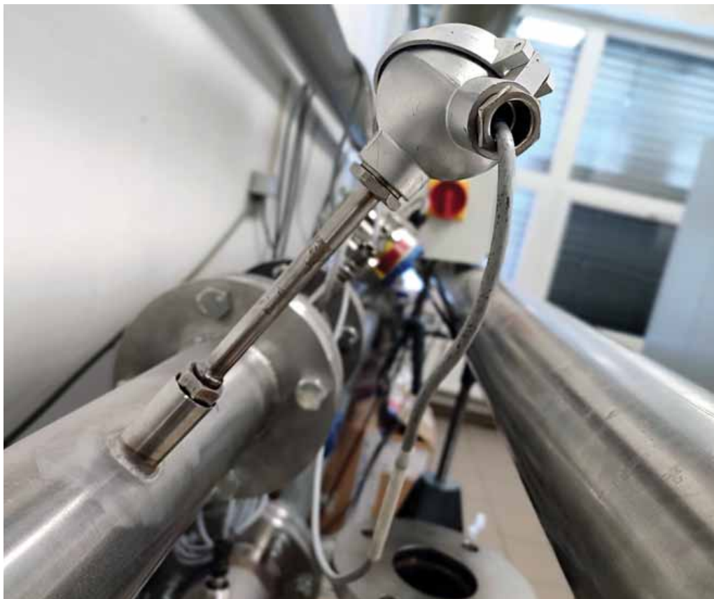
Rysunek 2. Czujnik temperatury zainstalowany na rurociągu
