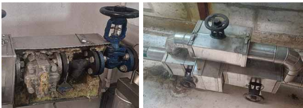
Rysunek 3 Skrzynki izolacyjne zaworów
