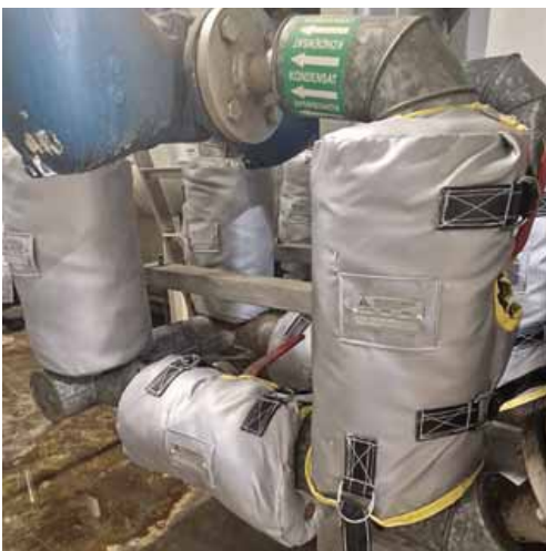
Rysunek 8 Czytelne znakowanie armatury dzięki tabliczkom znamionowym termoizolacji
