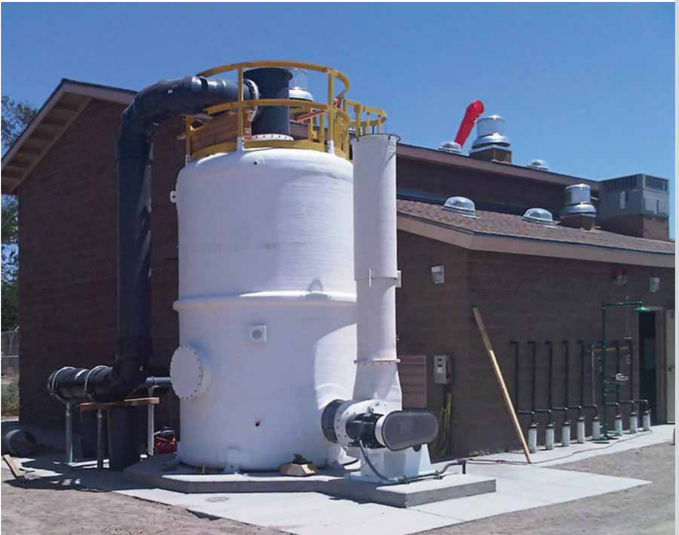
Rysunek 4 Budynek chlorowni wraz z instalacją suchej neutralizacji chloru
