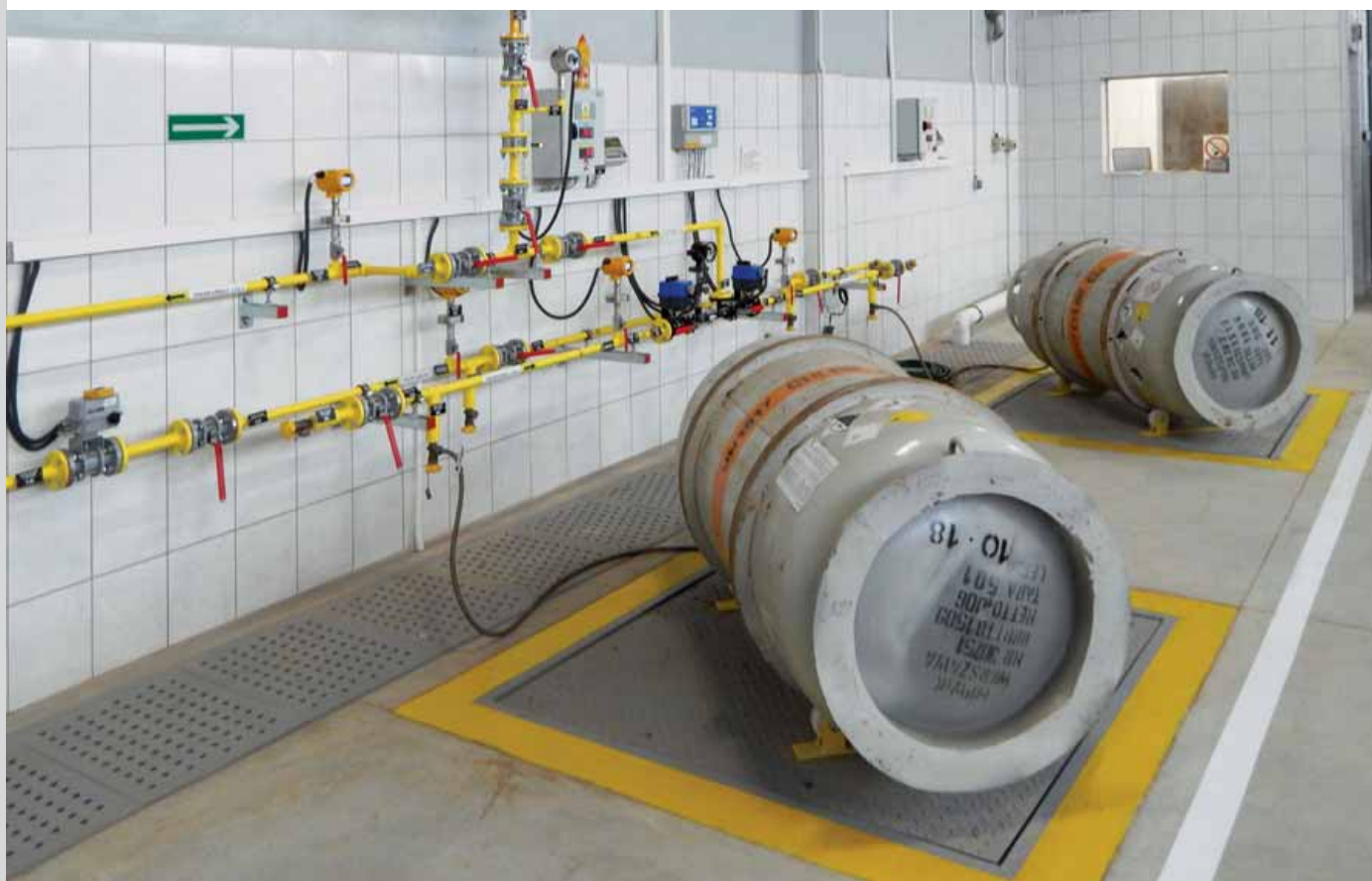
Rysunek 3 Magazyn beczek z chlorem i układ poboru chloru w fazie ciekłej z beczek-1000 kg chloru
