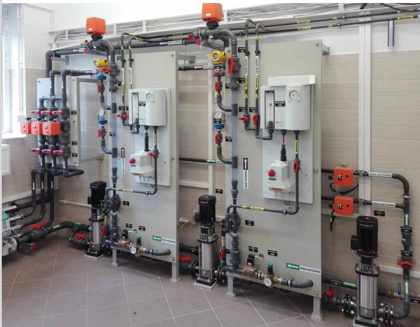
Rysunek 1 Układ dozowania chloru i wytwarzania wody chlorowej – pomieszczenie chloratorów
