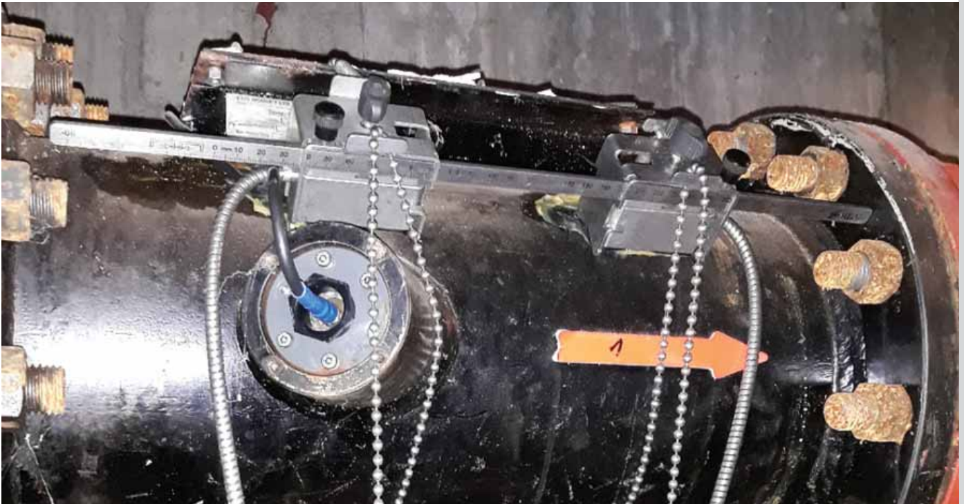
Rysunek 2 Sondy przepływomierza zamontowane na rurociągu
